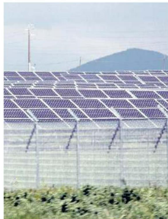
Una delle centrali a pannelli fotovoltaici di Montalto
