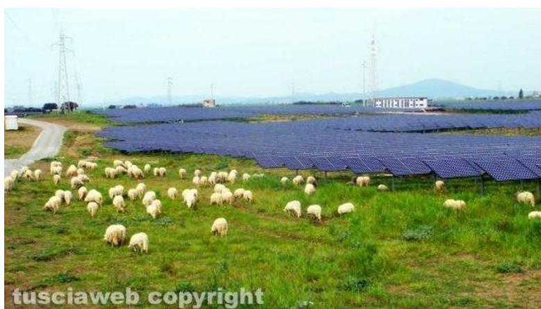
Montalto di Castro – Un impianto fotovoltaico
